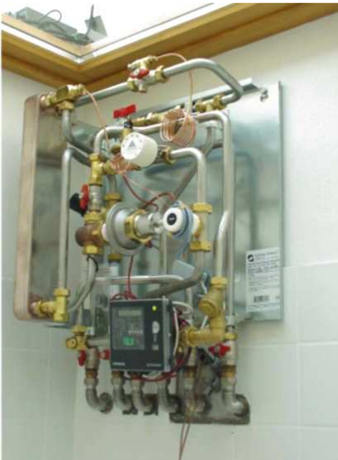
Abb. 11: Vormontierte Wohnungsstationen sind platzsparend und erleichtern die Montage. 1
