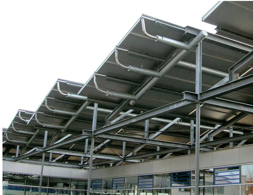
Abb. 18: Ausschnitt aus der freitragenden Dachkonstruktion über der Sporthalle in Neckarsulm-Amorbach mit 1252m 2 Kollektorfläche 1
