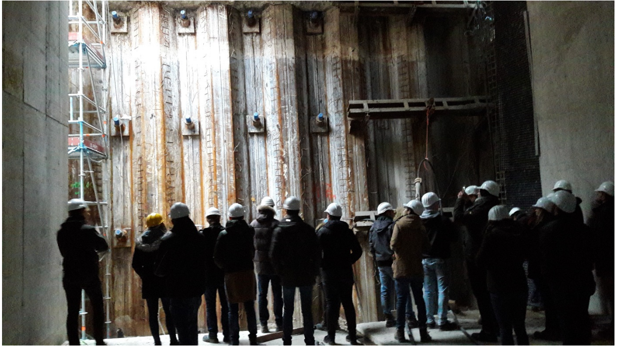
Bild 11: Baustelle Tunnel Kriegsstraße in Karlsruhe; Bereits fertig gestellter Tunnelabschnitt mit Abschottung zum nächsten Fertigungsabschnitt
